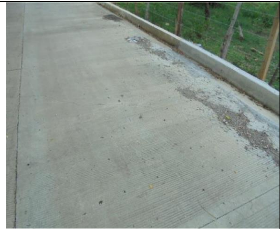
Descripción Registro Fotográfico: Placa Afectada Nro. 1
