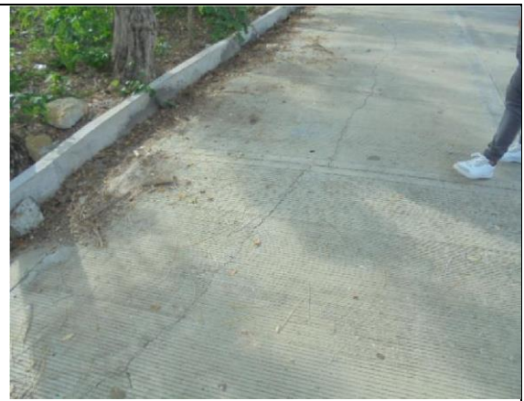
Descripción Registro Fotográfico: Placa Afectada Nro. 5
