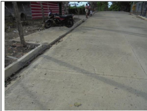
Descripción Registro Fotográfico: Placa Afectada Nro. 4
